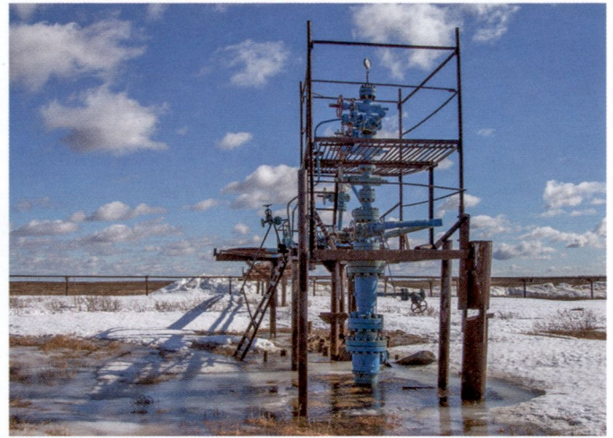
Промышленная скважина добычи газа. Северо-Солённой газоконденсатное месторождение
