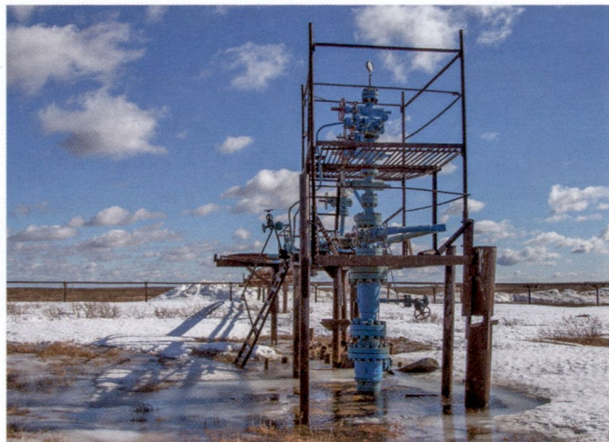
Промышленная скважина добычи газа. Северо-Солённой газоконденсатное месторождение
